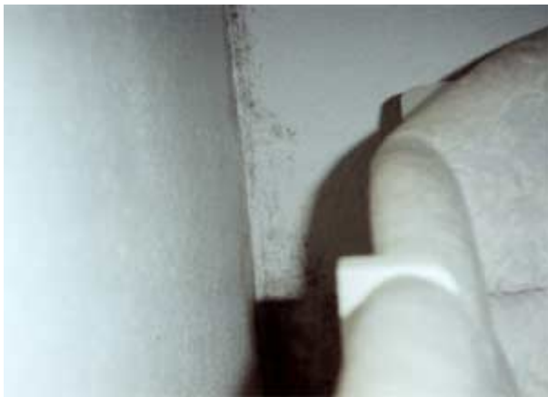
Bild 7.3.2.9.: Wärmebrücke an einer kalten Innenwand
