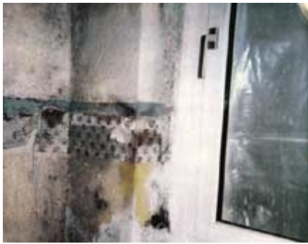
Bild 7.2.2.: Schimmelpilzbildung in einer Küche, Eckbereich zum Nachbarzimmer
