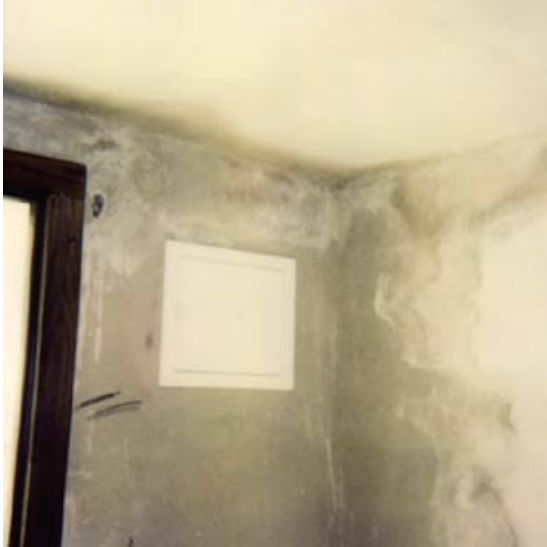
Bild 7.5.2.: Gipskalkputz im Kellerraum eines 1,5 Jahren Einfamilienhauses.
