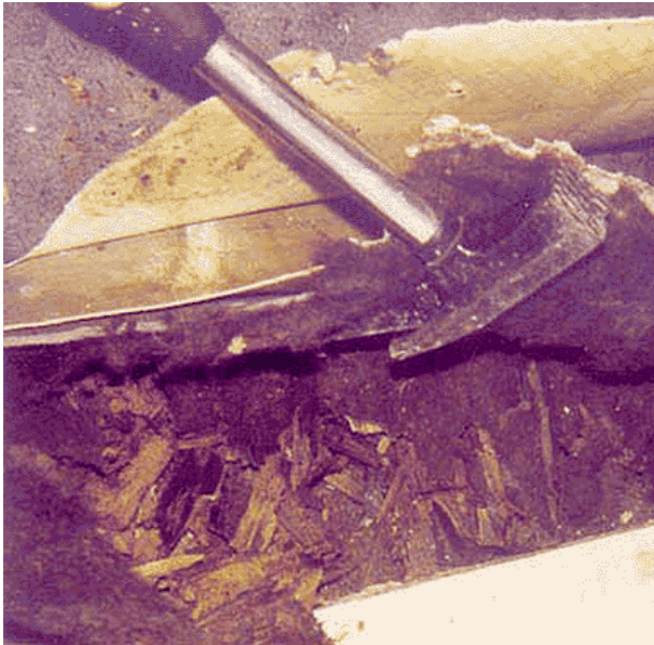
Bild 6.3.4.: Zerstörung einer Spanverlegeplatte und Dielung durch den Echten Hausschwamm und Schimmelpilze.
