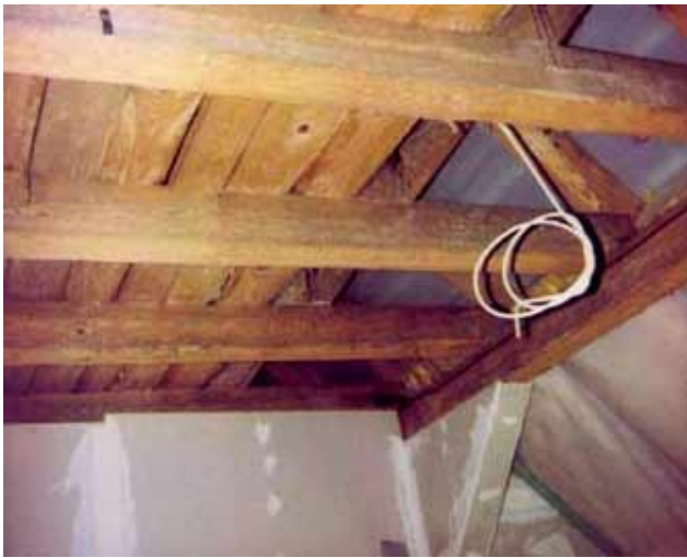
Bild 7.3.4.12.: Fehlende Anschlussmöglichkeit der Dämmung und der Dampfbremse
