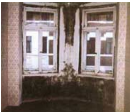
Bild 7.2.1.: Schimmelpilzbildung in einem Wohnzimmer am Erker
