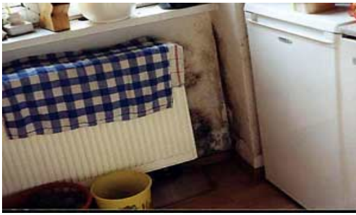
Bild 7.4.1.: Starke Durchfeuchtung der Außenwand
