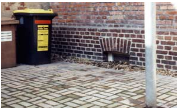
Bild 7.4.2.: Ein negatives Gefälle führt das Niederschlagswasser zur Außenwand und so zur Durchfeuchtung.
