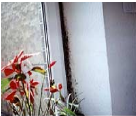
Bild 7.3.6.3.: Wärmebrücke neben dem Fensterrahmen
