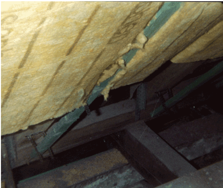
Bild 7.3.4.7.: Dämmung an einer Mittelpfette
