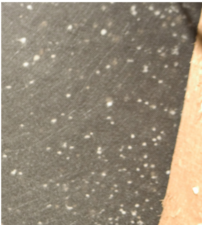
Bild 6.13.3.: Schimmelbefall an der Innenseite einer Unterspannbahn
